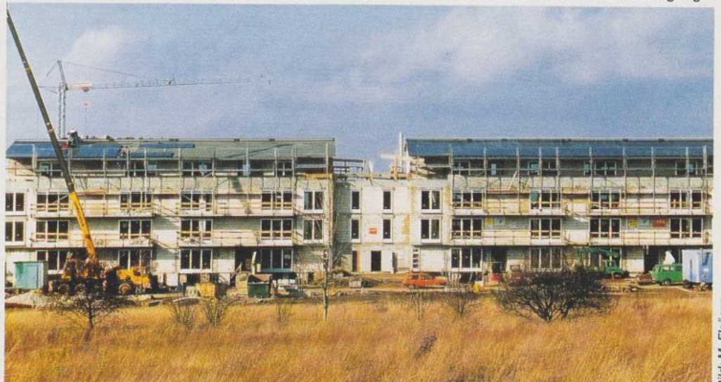
Moderne Wohnsiedlung in Neckarsulm mit großflächigen Kollektoren zur solaren Nahwärmeversorgung
